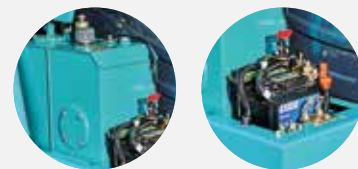
01 RÉSERVOIR DE CARBURANT, RÉSERVOIR HYDRAULIQUE ET BATTERIE
